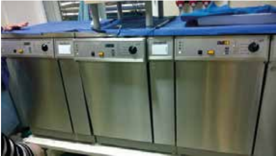
Kuva 10. Kystoskopiayksikön välinehuoltotilassa oli kolme tähystimen pesukonetta. Koneeseen mahtuu yksi tähystin kerralla.
