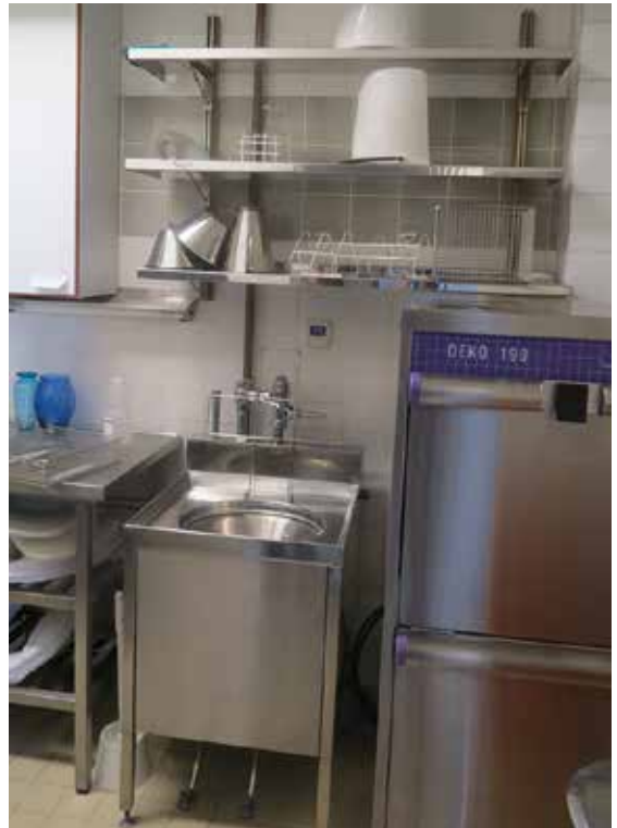
Kuva 1. Useassa huoltohuoneessa puhdas ja likainen puoli eivät olleet selkeästi erillään.
