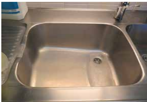
Kuva 2. Pinnat olivat kuluneita ja kalkkisia.
